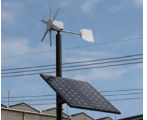
太陽光・風力発電式外灯
