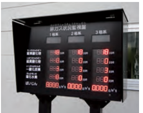
排ガス状況監視盤
