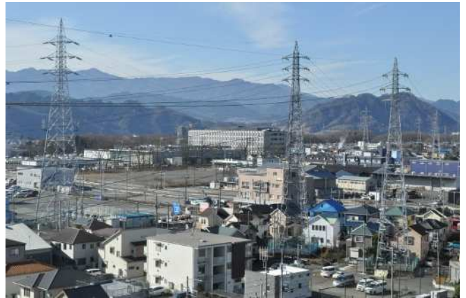
写真1 西橋本を通る送電鉄塔
