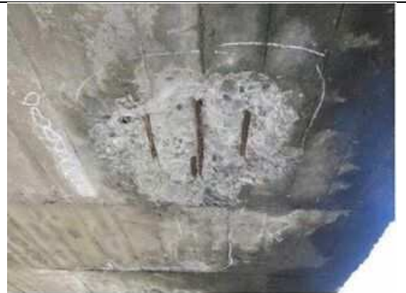
② 床版の損傷事例
