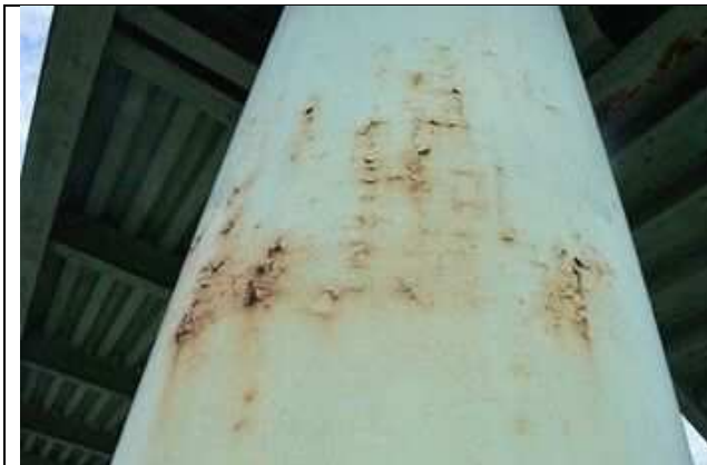
③下部工の損傷事例
