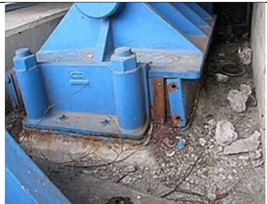
④支承の損傷事例
