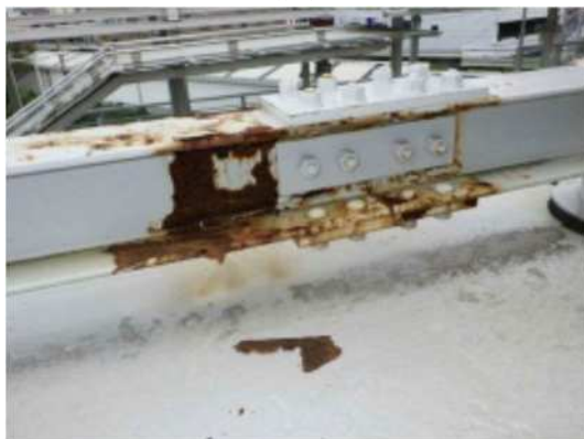
&lt;腐食・防食機能の劣化&gt;
