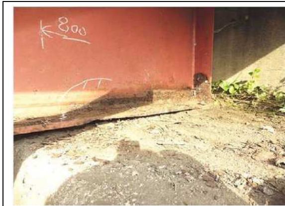
①主桁の損傷事例
