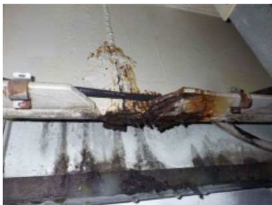
&lt;漏水&gt;
