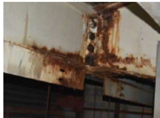
&lt;腐食・防食機能の劣化&gt;
