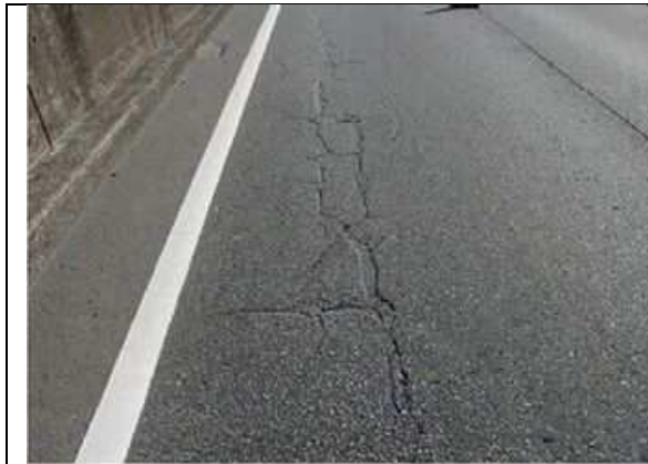
⑤路面の損傷事例
