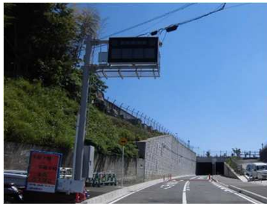
<新相武台トンネル：非常警報設備>
