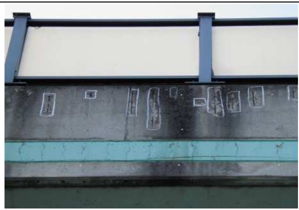
⑥高欄の損傷
