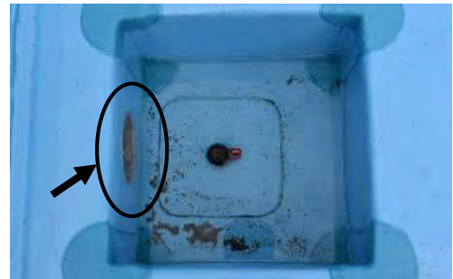
配管取付口(左側面矢印部分)
