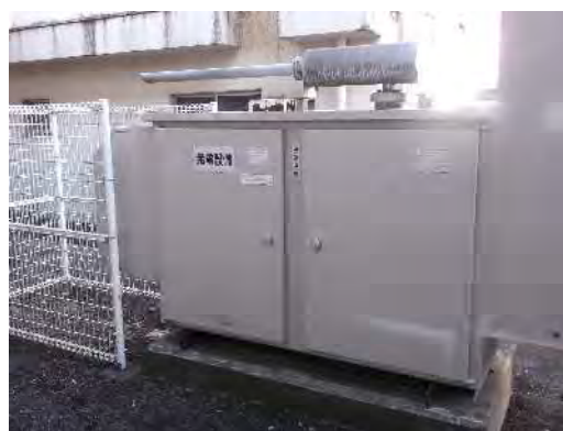
非常用発電設備（清新小学校）
