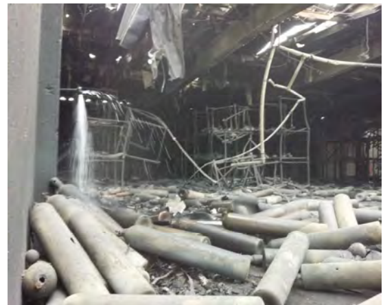
図2 鎮火後の現場
