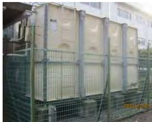
【緊急遮断弁付き受水槽】
