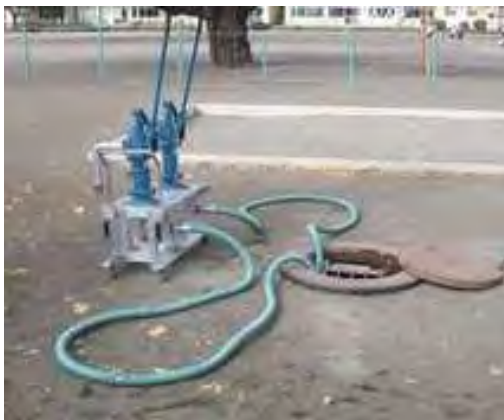
【飲料水兼用貯水槽】
