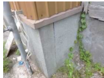
基礎のひび割れ
