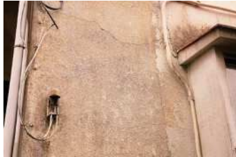
外壁のひび割れ・こけ
