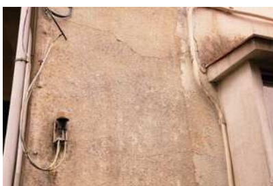
外壁のひび割れ・コケ
