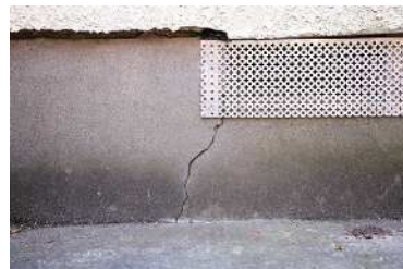
基礎のひび割れ
