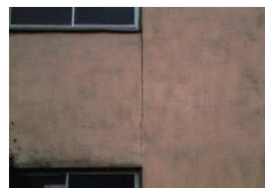
外壁のひび割れ
