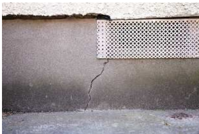
換気口付近のひび割れ
