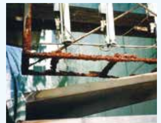
袖看板の底部脱落
