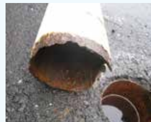
ポール看板の倒壊
