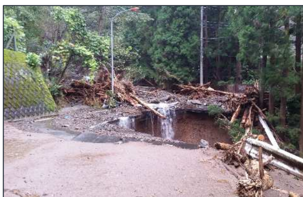
↑ 国道 413 号の道路崩落現場
