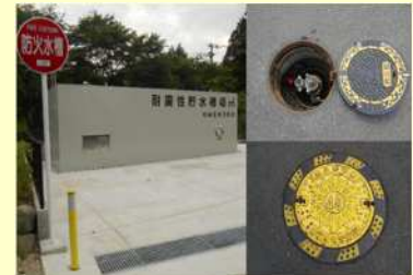
防火水槽（耐震性貯水槽）と消火栓
