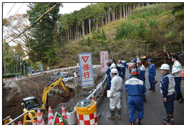
図表 3.1.14 津久井地区青根（国道413号）土砂崩落現場の視察状況
