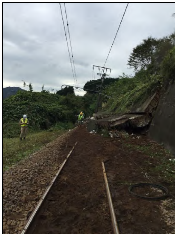
高尾～相模湖間(上り線)での土砂流入及びコンクリート壁崩落に係る復旧作業(10月15日(火)13時時点)
