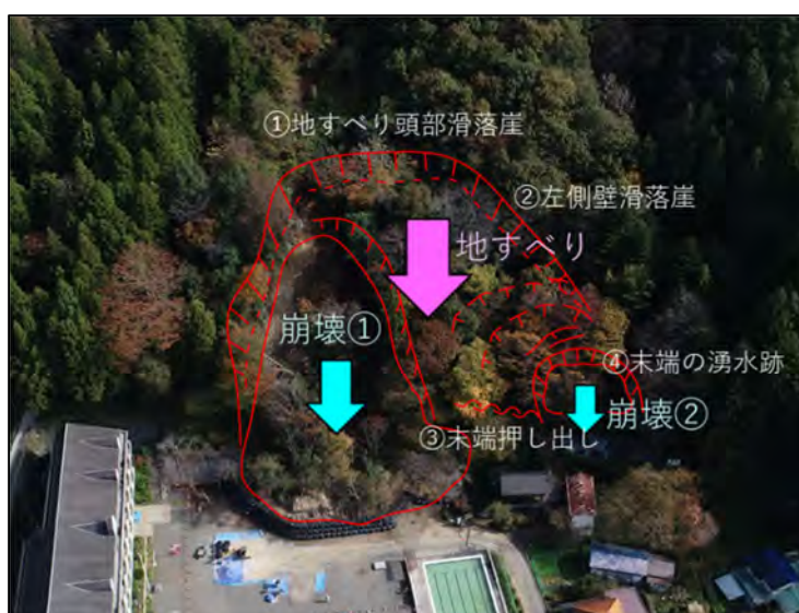
図表 3.12.7 藤野北小学校東側斜面の地すべりの概要
