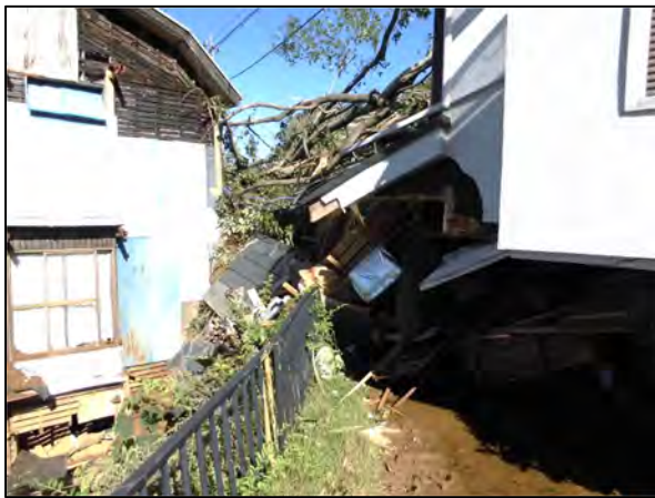
救助現場となった家屋（13日朝撮影）
