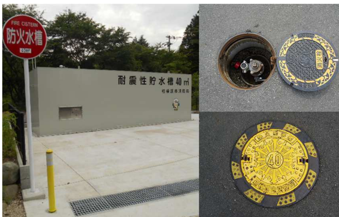
平成 30 年 12 月に整備した耐震性貯水槽（左） 消火栓（右上）・防火水槽の採水口（右下）
