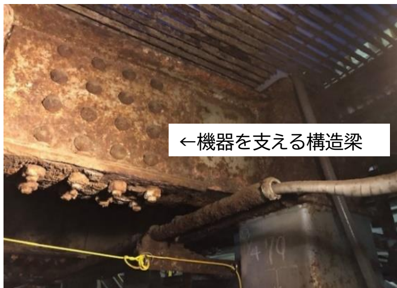
建物構造部の劣化状況(飛灰処理設備) ※湿度の高いエリアでは劣化が著しい
