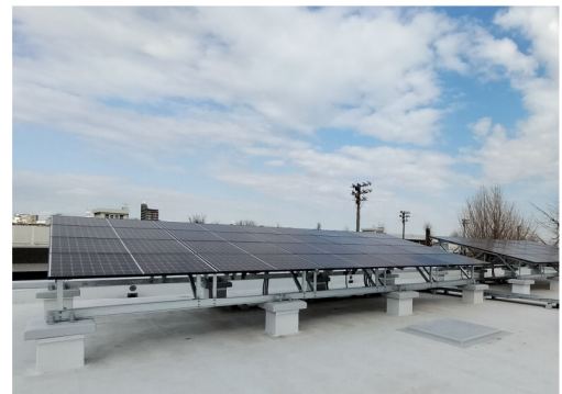
【太陽光発電設備の導入】
