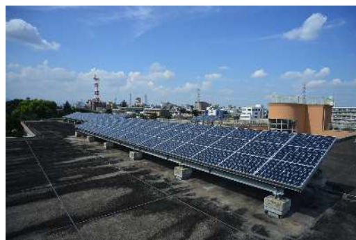
富士見小学校太陽光発電設備
