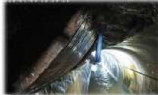
止水対策実施中（現況）
