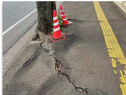
根上がりによる舗装の亀裂
