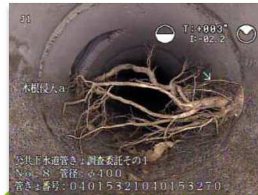
街路樹の根茎が下水管内に侵入
