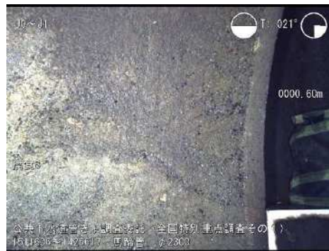
骨材露出（表面の摩耗）状況
