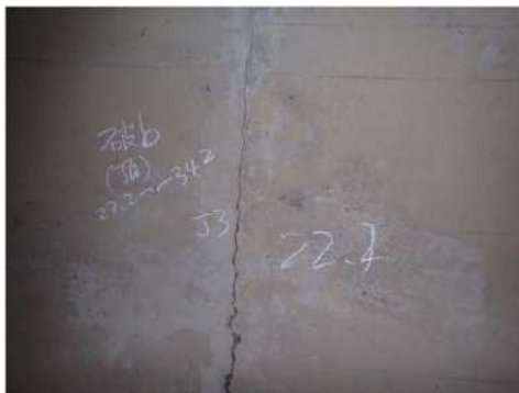
クラック（ひび割れ）発生状況
