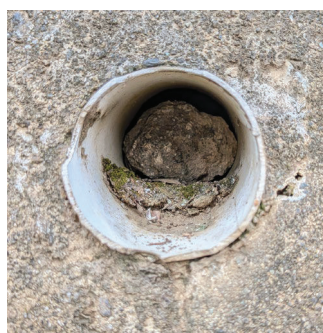
土砂の詰まり
