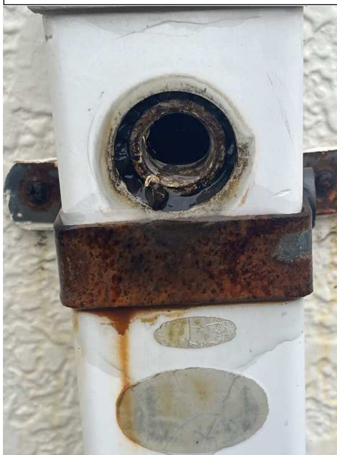
立水栓損壊部分
