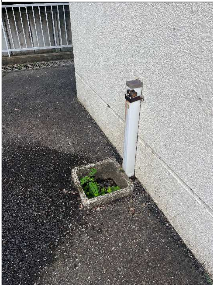
損壊された立水栓
