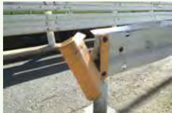
ガードレールの破損
